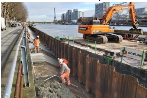
Travaux quai Blériot à Paris - Mise en œuvre du béton sur le perré © HAROPA PORT / DR
